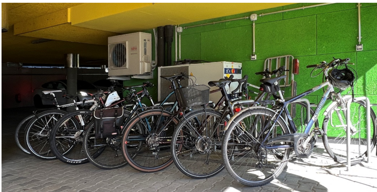
Abb. 3: Ebenerdig zugängliche Fahrradabstellanlage mit E-Lademöglichkeit, Eichenseher Ingenieure
